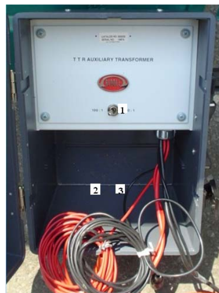
Figura 4 Transformador auxiliar para el TTR.
