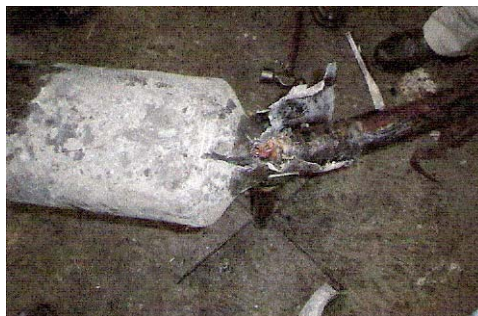
Figura 17. Cable 6 PT 1 × 70, falla provocada por reducido radio de curvatura.
