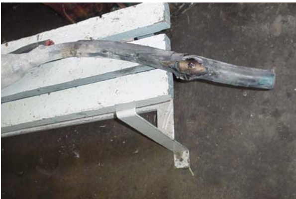
Figura 20. Cable 23 PT 1 × 240, falla provocada por mal manejo en la instalación del cable.
