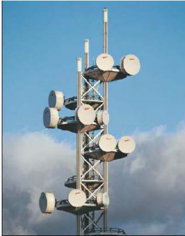
Figura I.5. Torre que soporta antenas de microondas terrestres.
