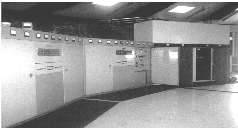
A la izquierda los transmisores que fueron utilizados de refacciones. A la derecha el de 100 kw que llegó con piezas faltantes. Foto IMER
