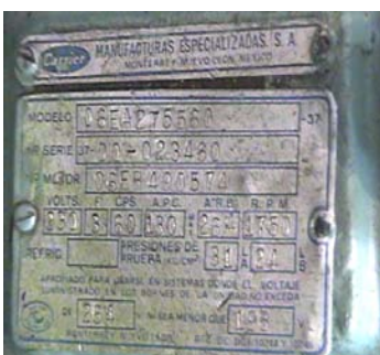
Datos de placa de uno de los compresores.
