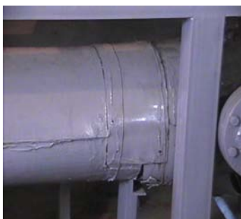
Daños visibles al casco de una de las unidades.
