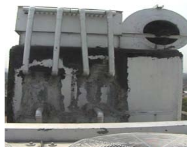
Torre de enfriamiento de las unidades.
