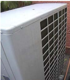
Unidad condensadora ubicada en el exterior.
