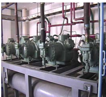
Unidades Generadoras de Agua Helada, cada una cuenta con dos compresores.
