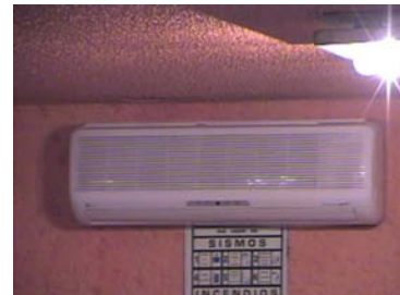
Unidad evaporadora ubicada dentro del hotel.
