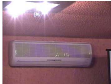
Unidad evaporadora ubicada dentro de una habitación.
