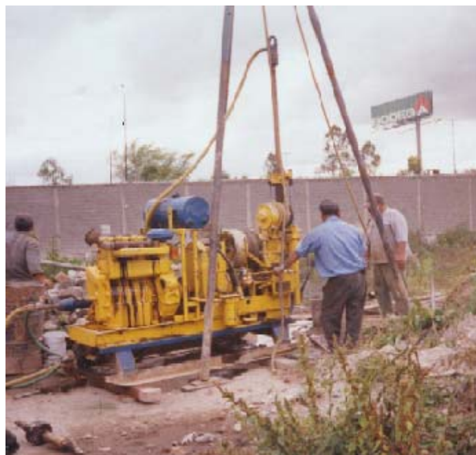
En la fotografía se observa en equipo de perforación en la realización del sondeo profundo.
