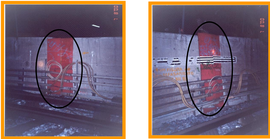
Tapajuntas existentes en sección tajo (abierto) Fotografía VI.1 y VI.2
