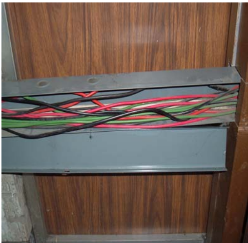
SISTEMA DE CABLEADO
