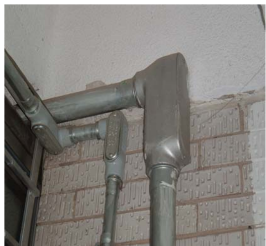
SISTEMA DE CANALIZACIÓN
