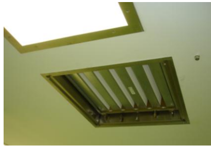
Figura. 1.6.2 Filtros para contención de partículas externas, a nivel plafón, en áreas de proceso
