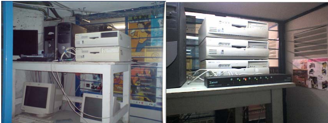
Fig. 3-9 Cuarto de equipos
