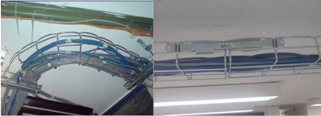
Fig. 3-2 Distribución de cables en charola tipo malla
