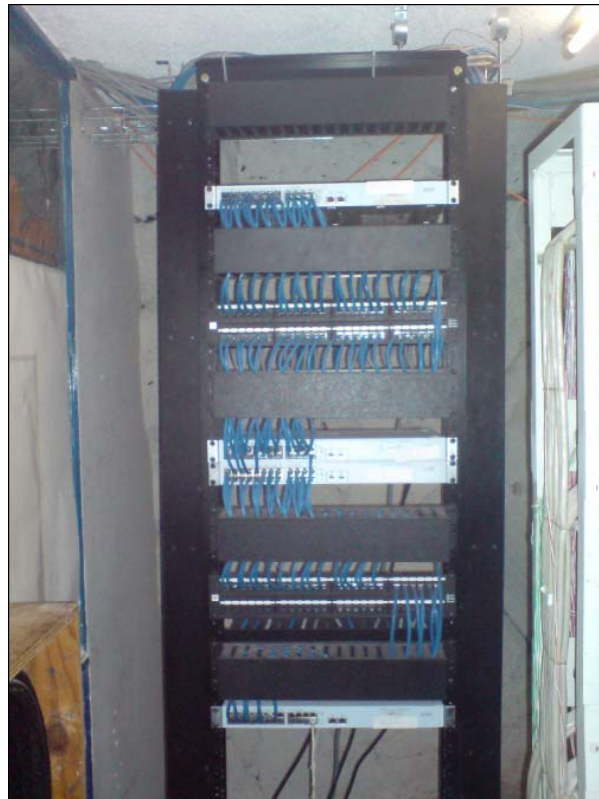
Fig. 3-6 Rack de telecomunicaciones.
