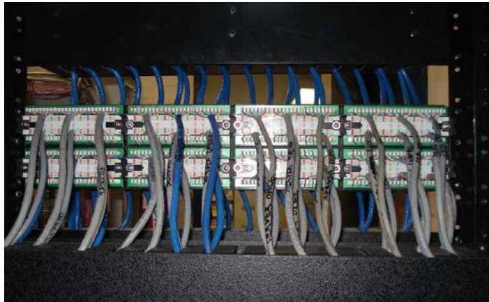
Fig. 3-7 Acercamiento al panel de parcheo
