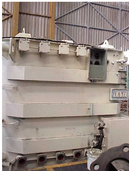
Figura 1.4.4 Tanque de un transformador
