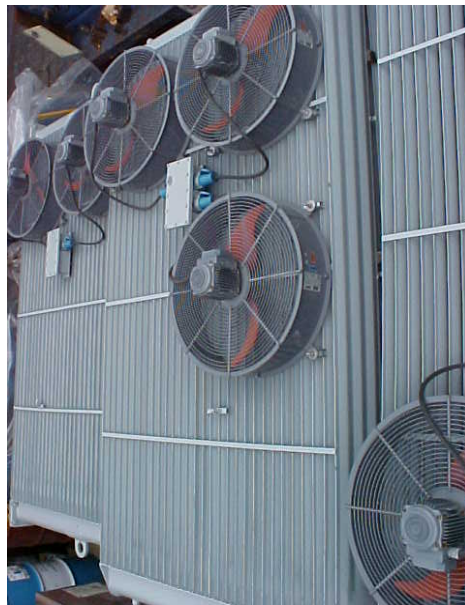
Figura 1.5 Radiadores y ventiladores
