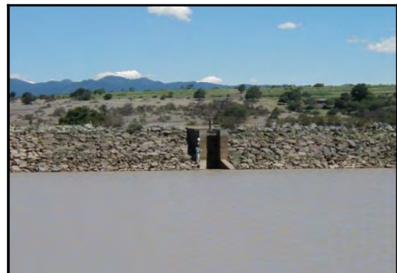
Zona de la compuerta en el mes de junio, en esta imagen se aprecia la disminución del volumen en la parte más profunda del cuerpo.
