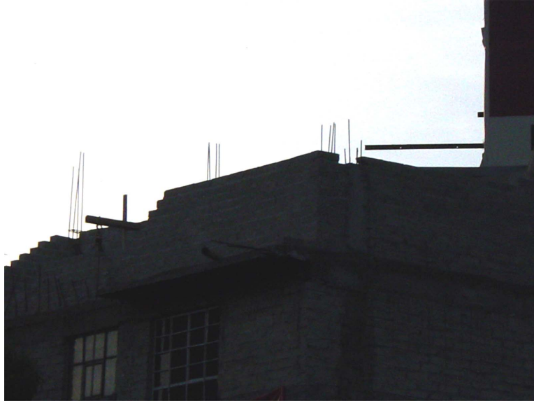
Figura 17. Es muy común ver en de salida por cualquiera de las carreteras de la Ciudad de México, y hasta en el interior de ella, vistas como ésta (toma en la autopista México-Puebla); se pensaría que es una obra en proceso, pero se convierte en una obra que nunca se termina, y así se queda: gris y con las varillas salidas.
