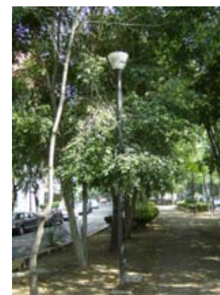
Fig. 3.52 Luminaria sobre el camellón de Ámsterdam
