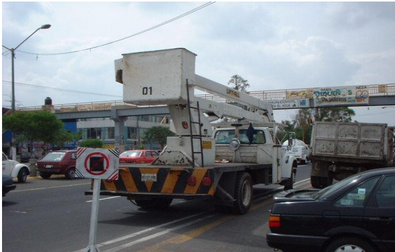
Servicio de mantenimiento de energía eléctrica
