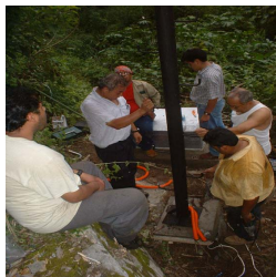
Figura 3.8 Instalación de celda solar incluye fabricación e instalación de torre, base para celda solar y baterías.
