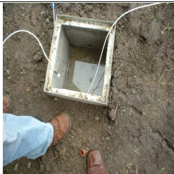
Figura 3.7 Registro de concreto para suministro de servicios (GPS, energía eléctrica e Internet).
