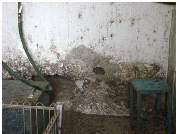
Figura 13. Pared sin mantenimiento.
