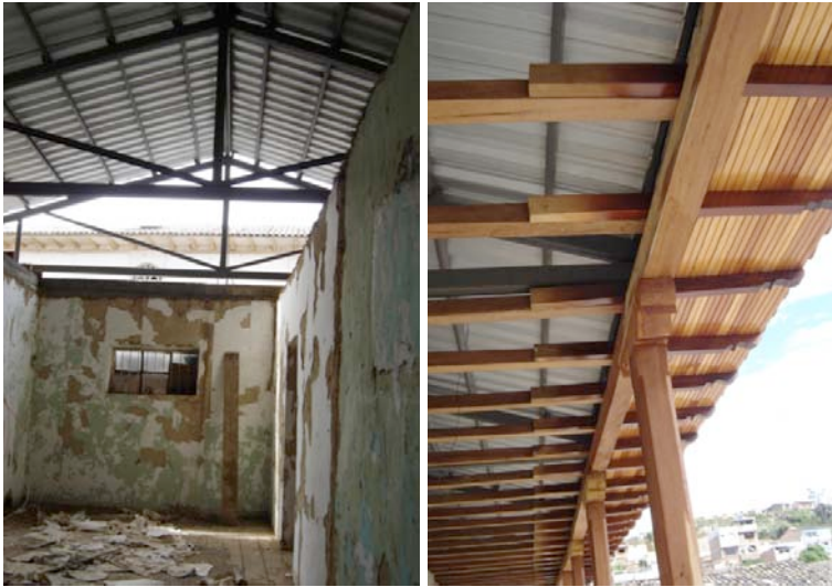
Imagen 4.14: Los sistemas constructivos de la cubierta de la casa Parroquial empleados no tienen nada que ver con su integración.
