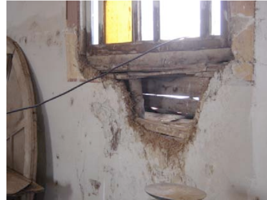
Imagen 4.8: Deterioro del vano de la nave lateral izquierda Fuente: El autor
