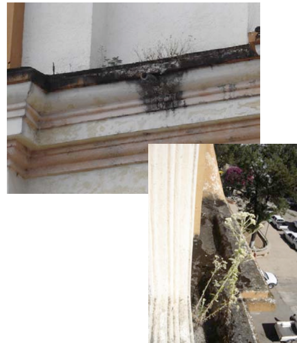
Imagen 4.11: Deterioro de la fachada frontal de la iglesia Fuente: El autor
