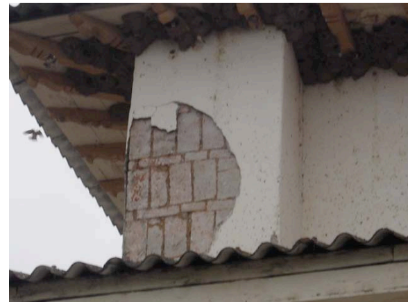
Imagen 4.9: Deterioro del muro de una esquina de la iglesia. Fuente: El autor
