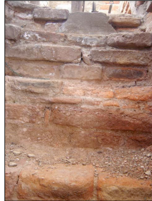
Imagen 4.6: Deterioro de las gradas que suben al campanario Fuente: El autor
