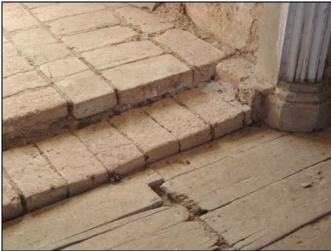
Imagen 4.7: Deterioro de la entrada del Coro Fuente: El autor
