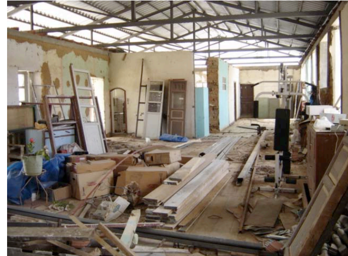
Imagen 4.13: Destrucción masiva de los muros de adobe en la planta alta de la casa parroquial. Fuente: El Autor
