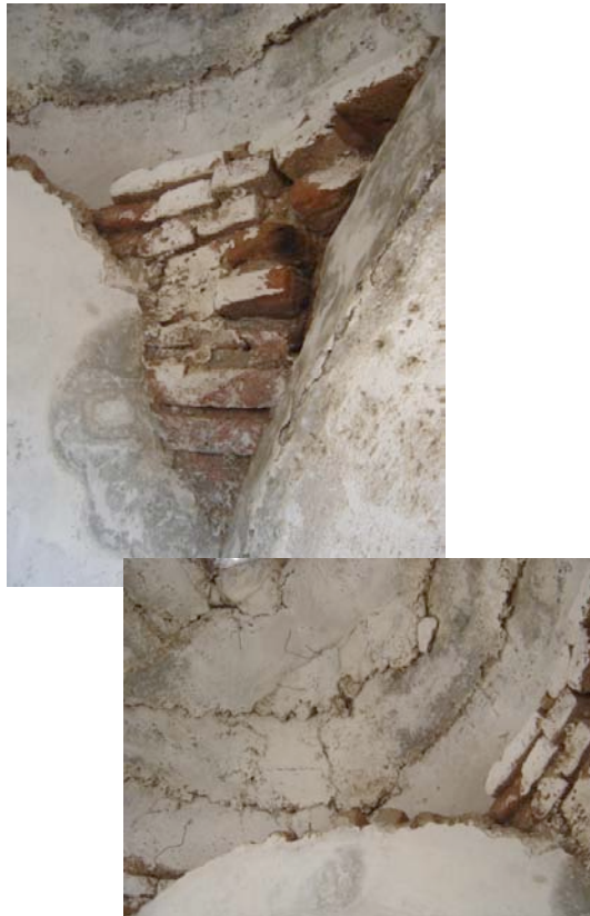
Imagen 4.10: Deterioro de la cúpula de la iglesia Fuente: El autor
