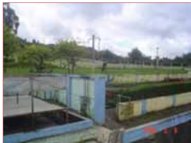
PARQUE PUCARA, LOJA ECUADOR, Antigua planta de tratamiento de agua potable, hoy parque recreacional, muy peligroso, Fuente: AUTOR, 2008
