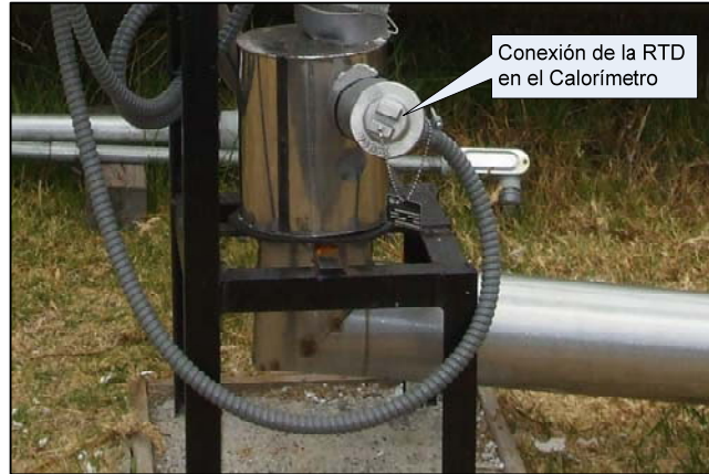
Figura 4.16. Conexión de la RTD en el Calorímetro.
