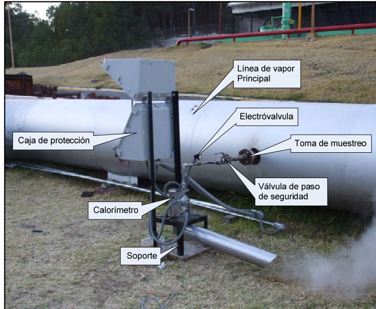
Figura 4.13 Instalación del calorímetro en sitio.
