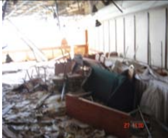
DAÑOS EN PLAFOND Y MOBILIARIO
