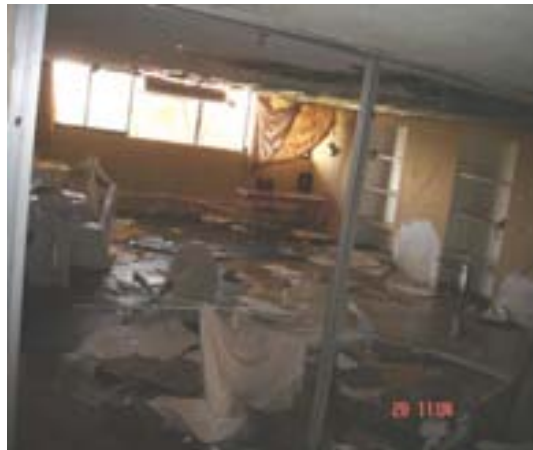
DAÑOS EN CANCELERIA
