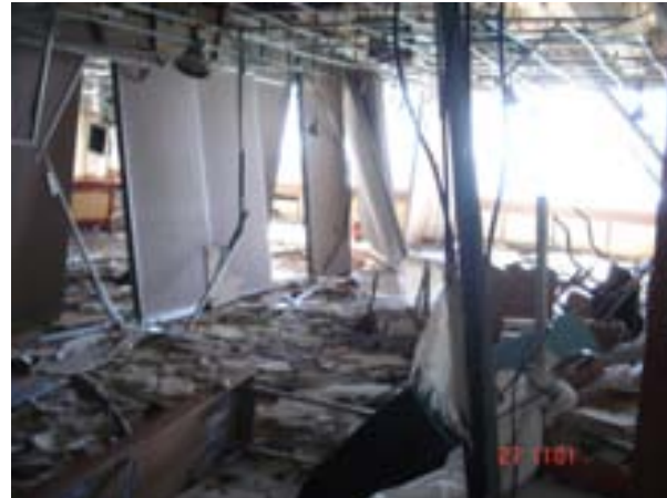
DAÑOS GENERALES EN SALONES
