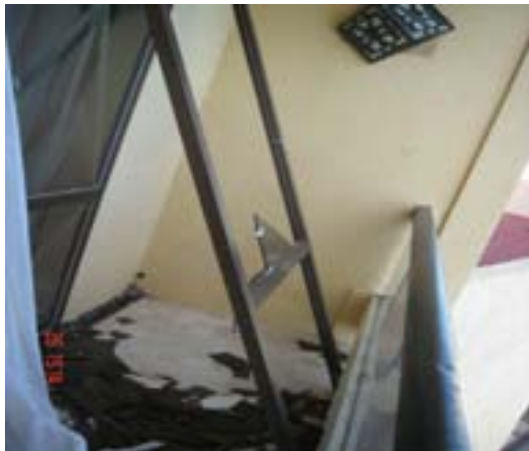
CANCELERIA DAÑADA DE BALCON
