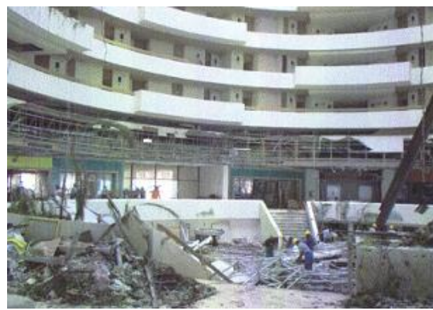
MATERIALES DESTROSADOS EN LOBBY
