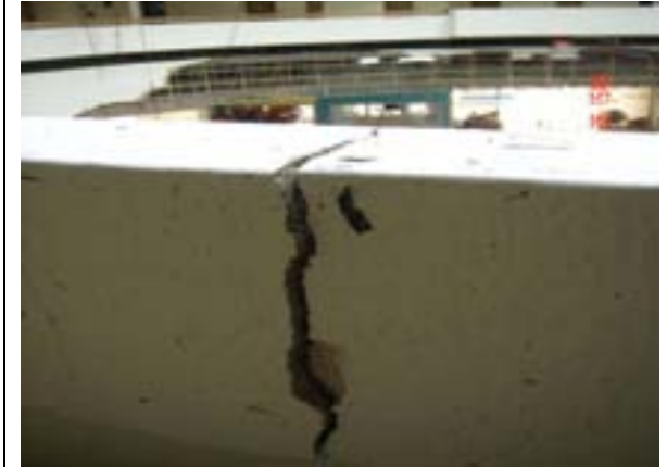
DAÑOS EN BARANDAL 1
