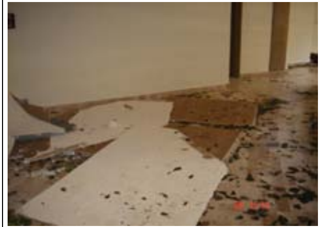
DESECHOS DE CARPINTERIA Y TABLAROCA EN PASILLO
