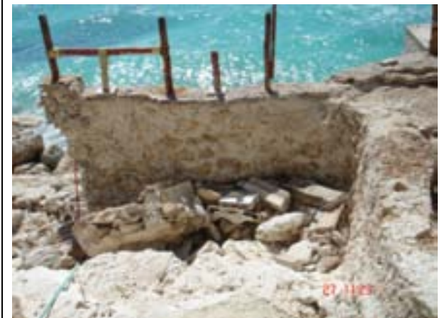
DAÑOS EN ESCALERA HACIA LA PLAYA
