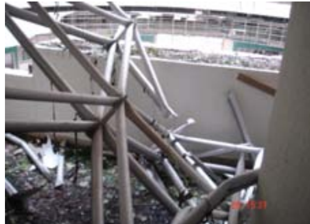
DESECHOS DE DOMO EN PASILLO NIVEL 1
