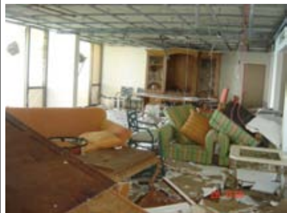
DAÑOS EN PLAFOND
