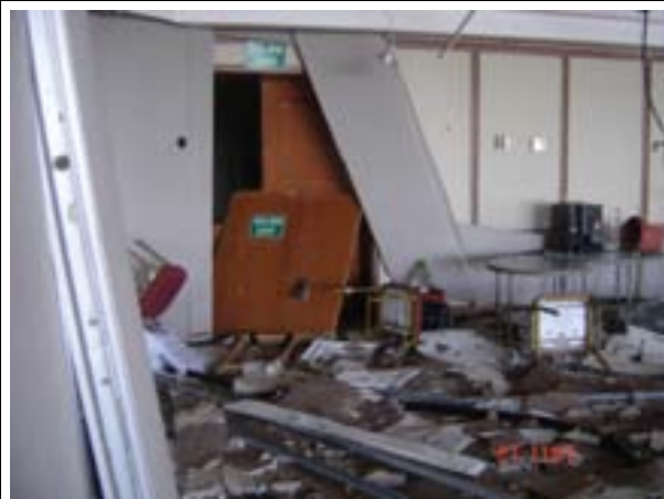
DAÑOS EN ACCESO Y MUROS
