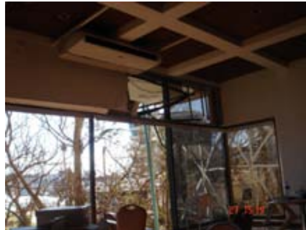
CANCELERIA Y MOBILIARIO DAÑADO
