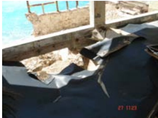
AFECTACIÓN EN PISO Y CANCELARÍA
