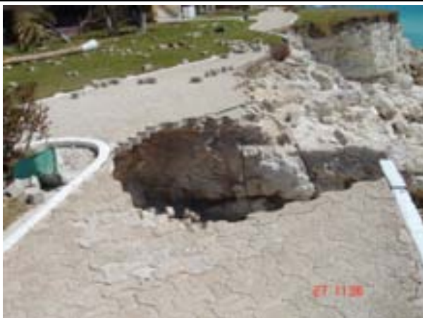
DAÑOS EN ANDADORES
