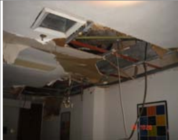
DAÑOS EN INSTALACIONES
