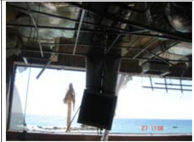
EQUIPOS DE AIRE ACONDICIONADO
