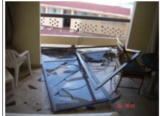
PERDIDA TOTAL DE CANCELERIA
