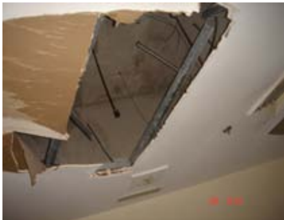
DAÑOS EN PLAFOND, OF. CAPASITACION
