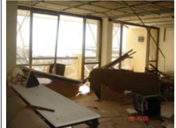
DAÑO EN CANCELERIA
