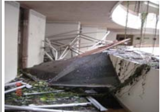
DESECHOS EN PASILLOS NIVEL 1
