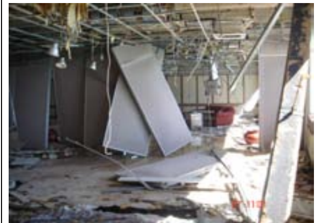
DAÑOS TOTAL EN SALONES
