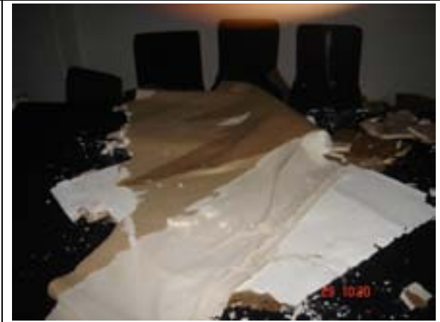
AFECTACION EN AREA DE JUNTAS
