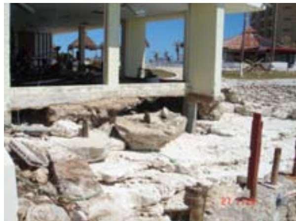
VISTA LATERAL, DAÑOS A CIMENTACION
