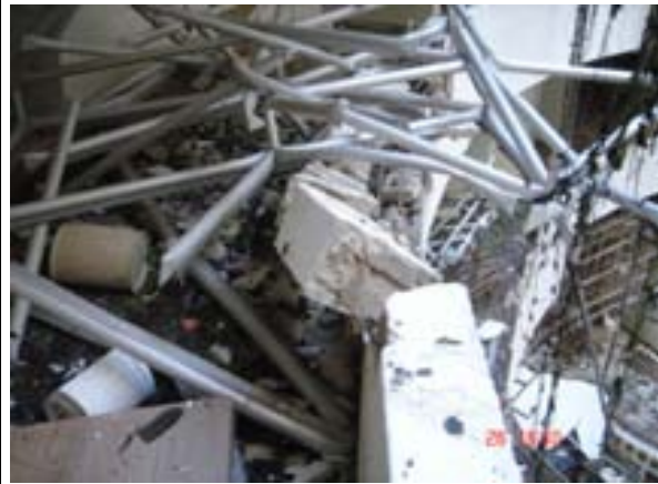
DESECHOS EN PASILLO NIVEL 2
