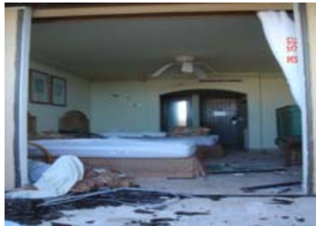
PERDIDA TOTAL DE CANCELERIA
