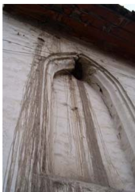
Desprendimiento de enlucidos por humedad. Autor 2006
