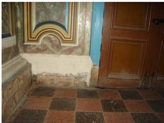
La acción de sales, ha permitido que se pierda la decoración de muros en iglesia. Autor 2006
