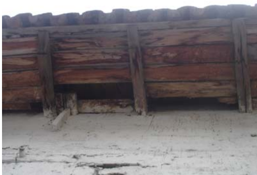
Se aprecian la madera de alero en mal estado, debido a la humedad, por mal estado de cubierta. Autor 2006
