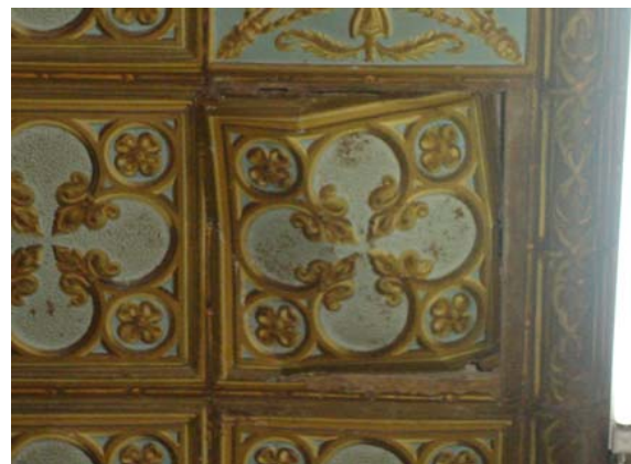
Desprendimiento de plafones. Autor 2006
