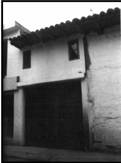
Construcción adyacente a la Iglesia. Autor 1996
