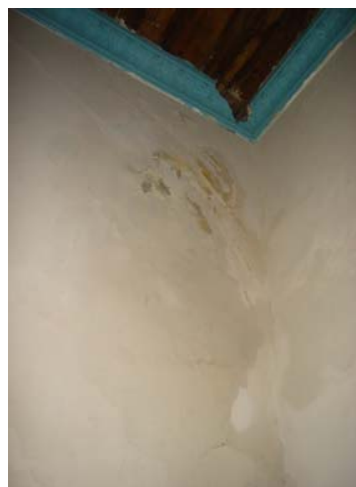
Presencia de humedad por cubierta en mal estado. Autor 2006
