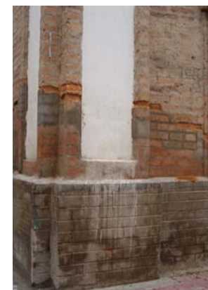
Erosión en algunos ladrillos de fachada. Autor 2006
