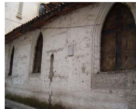
Desprendimiento de enlucidos por humedad, falta de mantenimiento. Presencia de cables. Autor 2006
