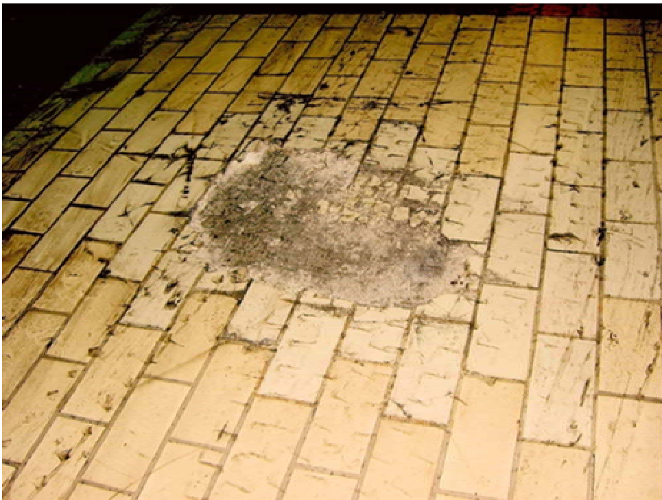
Foto 1. Daños mayores ocasionados en pisos de loseta antiácida
