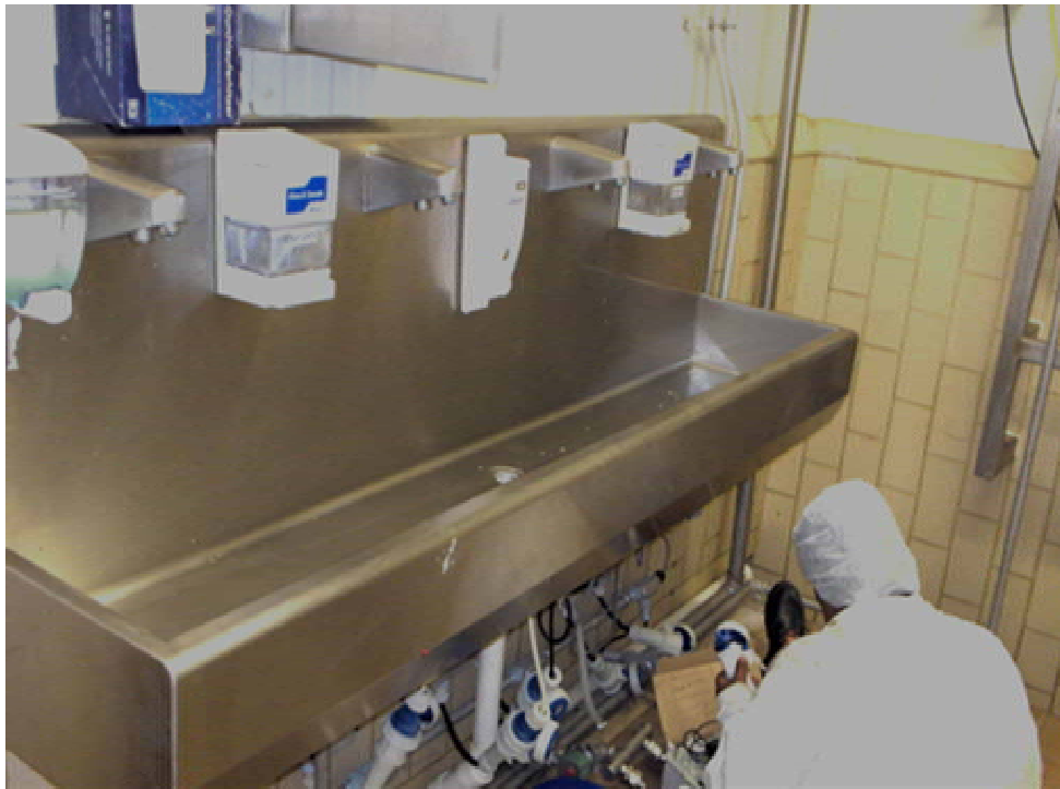
Foto 20. Instalación de lavabo de acero inoxidable de cuatro puestos, en el Mantenimiento Modificado de las aduanas sanitarias
