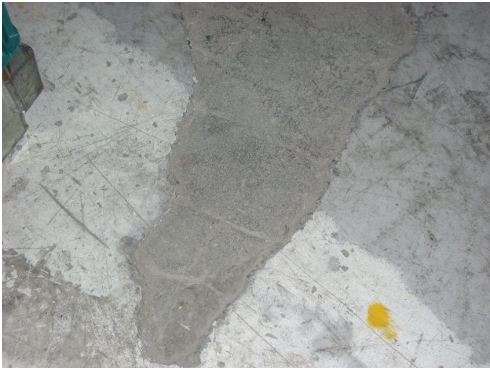
Foto 27. Se observa los parches excesivos en el piso de concreto con recubrimiento epóxico
