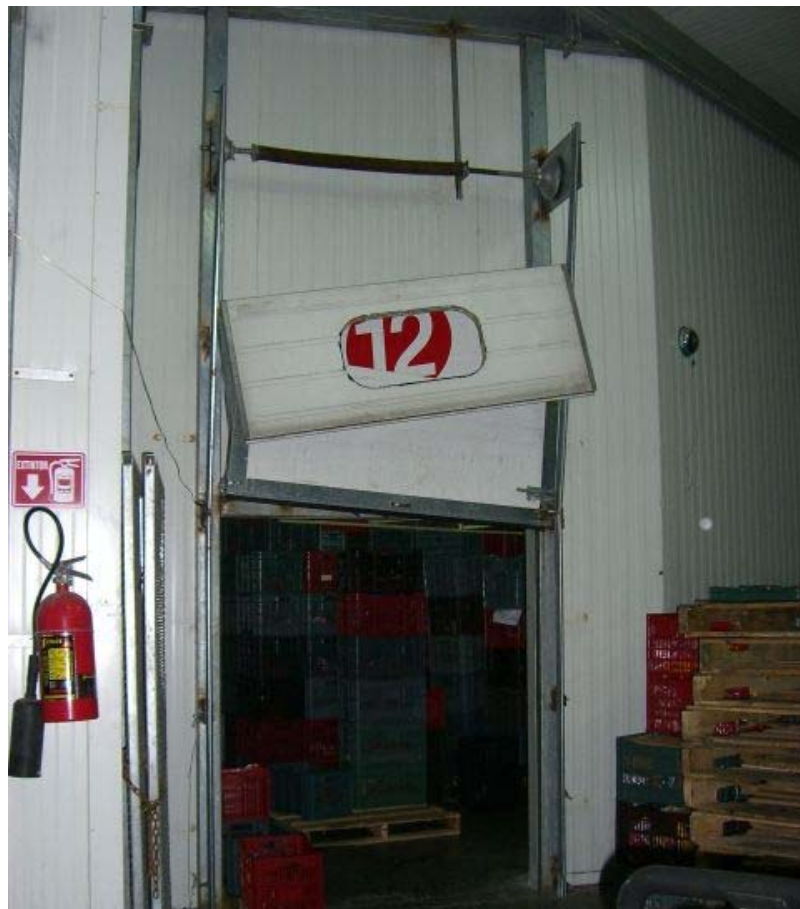
Foto 5. Puerta overhead en mal estado, en el área de andén de carga
