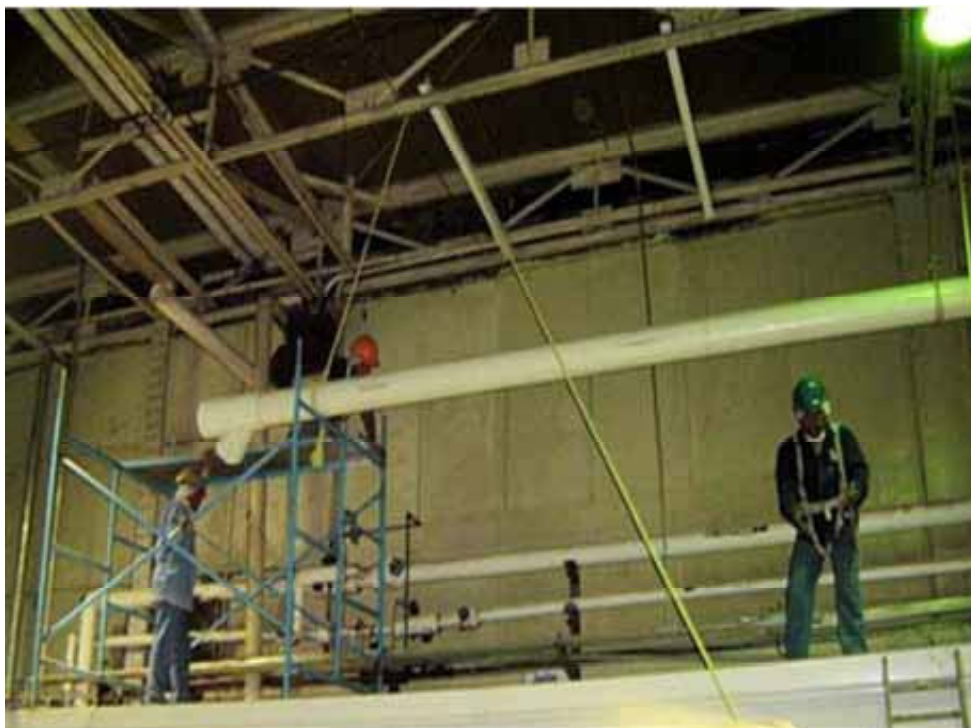
Foto19. Mantenimiento Modificado aplicado a una nueva instalación pluvial, para cumplir con la normatividad mexicana vigente
