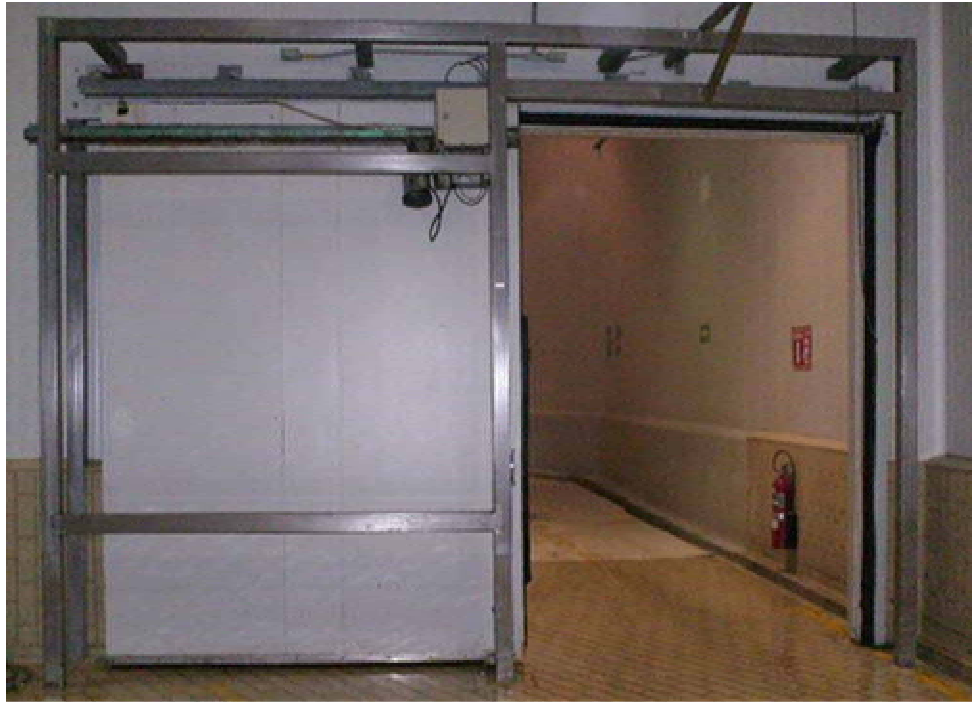
Foto 12. Protección de puerta corrediza automática, a base de un doble marco de ptr de acero inoxidable calidad sanitaria t-304
