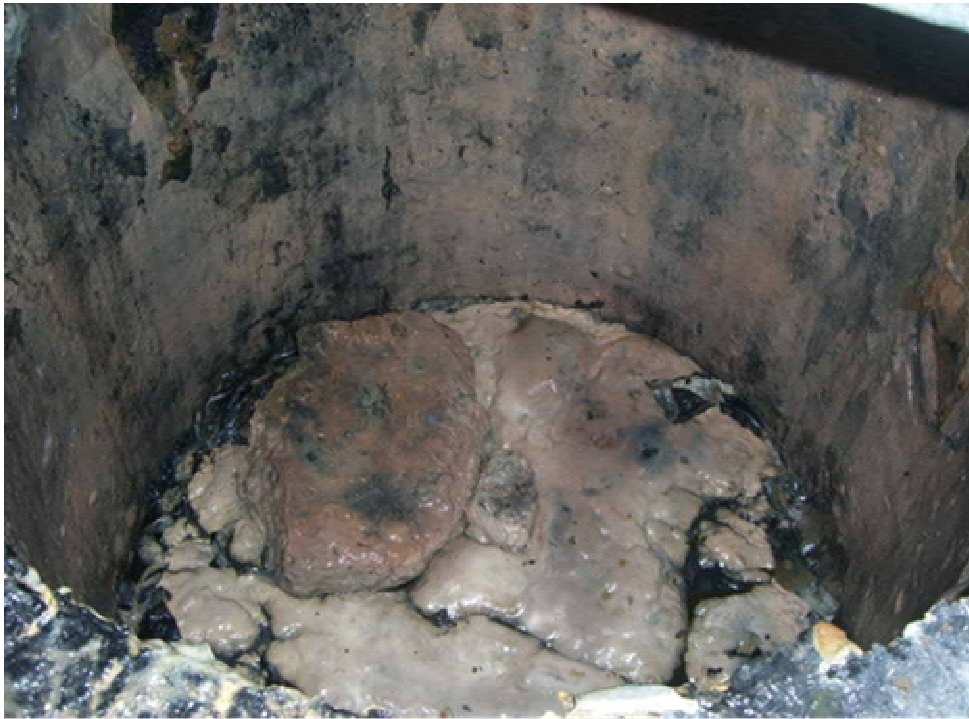
Foto15. En este pozo de visita se observa en el fondo una cantidad considerable de sólidos
