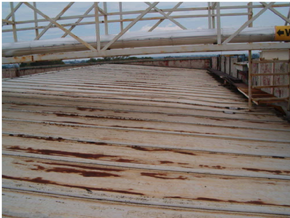
Foto 8. Obsérvese la corrosión sobre la lámina de la techumbre de multypanel, por la falta de Mantenimiento
