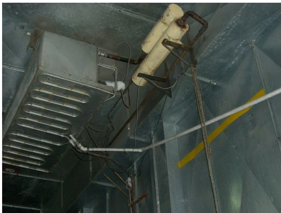
Foto 29. Equipo de refrigeración con consumo de energía muy alto
