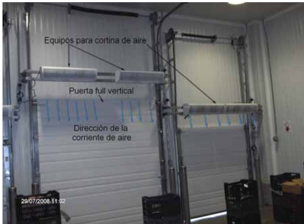
Foto 31 Puertas full vertical equipadas con cortinas de aire, para evitar la introducción de insectos
