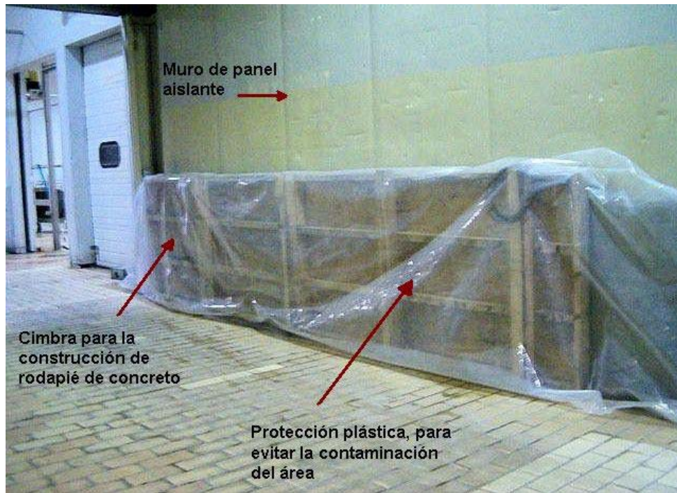
Foto 11. Protección de multypanel por medio de rodapié de concreto reforzado, que posteriormente será recubierto con loseta antiácida
