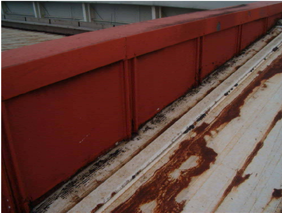
Foto 9. Vista parcial de la corrosión sobre la lámina de la techumbre de multypanel, por falta de Mantenimiento
