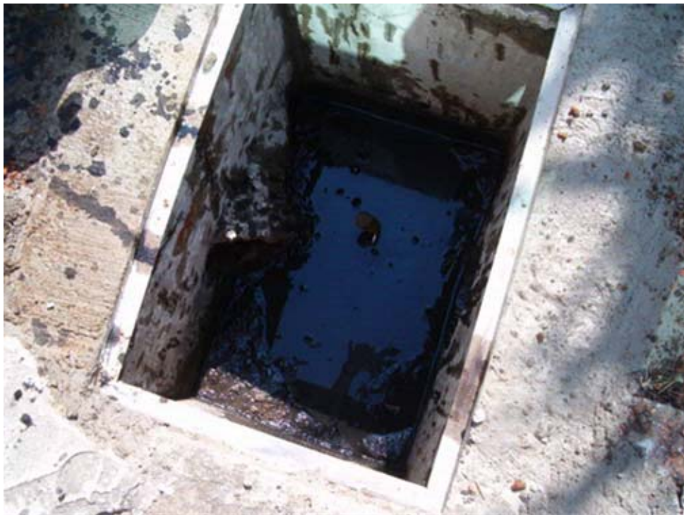
Foto 14. En este registro se observa que en el fondo se empieza acumular residuos sólidos
