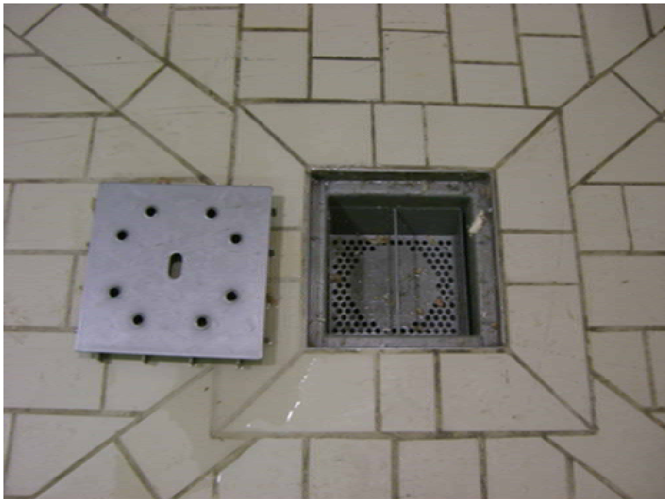
Foto 13. La instalación de sumideros sifónicos de acero inoxidable, tuvo un impacto positivo pues se evita el Mantenimiento Correctivo del correspondiente desazolve de los registros y cañerías internas
