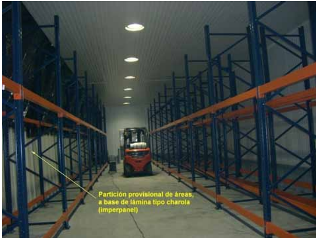
Foto 32. Las particiones provisionales, permitieron reducir el riesgo de contaminación de los productos almacenados, mientras se realizaba el proyecto de Mantenimiento
