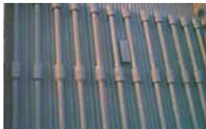
Fig. 68. Instalación de tuberías de cobres en desuso, que pueden ser reutilizados como ductos de suministro de aire caliente
