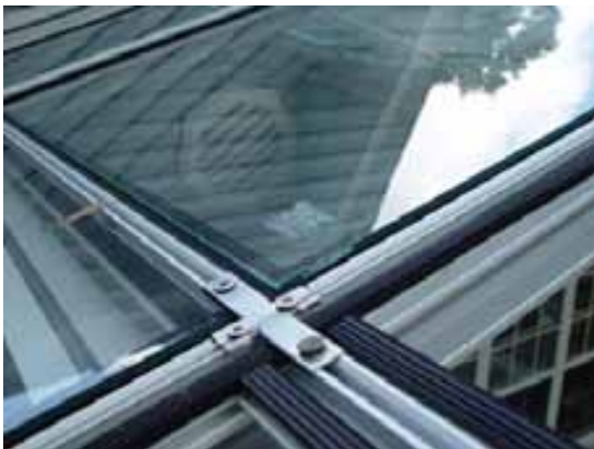
F.122. Detalle de superficie acristalada en techo
