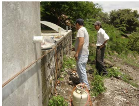
Figura 4.21 Instalación de gas para el quemador del GFD
