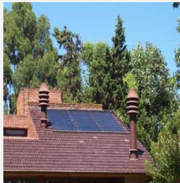
Sistema de paneles fotovoltaicos
