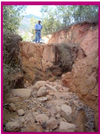
Figura 2. Desprendimiento de un banco de Material
