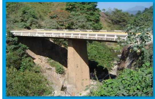
Figura 5. Puente en mal estado.
