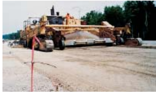
Fig. 6-1. Se da la forma a la capa de base para el pavimento de concreto con un auto-nivelador a fin de diseñar el perfil, la sección transversal y el alineamiento, a través de sensores automáticos que siguen las líneas de referencia
