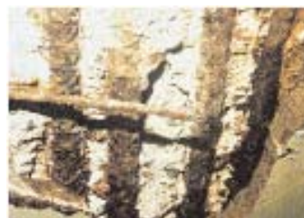
Fig. 3-18. Los daños en esta estructura de estacionamiento en concreto son resultado de la corrosión de la armadura, inducida por cloruros.
