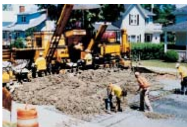
Fig. 6-6. Los camiones basculantes depositan el concreto delante de la pavimentadora de cimbras deslizantes, la cual coloca a todo lo ancho de una calle en una sola pasada. Las barras de transferencia (pasadores) con revestimiento de epoxi sobre canasto metálico se posicionan en la junta y se clavan en la capa de base delante de la pavimentadora.
