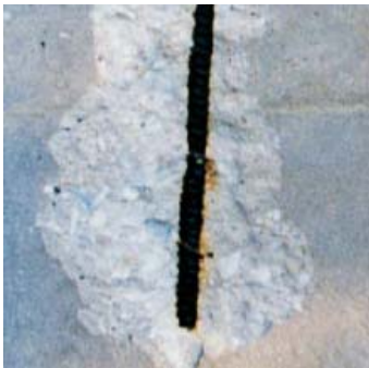
Fig. 1-8. La Carbonatación destruye la habilidad del concreto de proteger el acero embebido contra la corrosión. Todo concreto carbonata hasta una pequeña profundidad, pero la armadura debe tener un recubrimiento adecuado para prevenir que la Carbonatación alcance el acero. Esta barra de armadura en un muro tenía menos de 10 mm (0.4 pulg.) de recubrimiento de concreto; El código de construcción del ACI requiere un recubrimiento mínimo de 38 mm (1 1/2 pulg.). Después de años de exposición al aire, el concreto carbonató hasta la profundidad de la barra, permitiendo que el acero se oxidara y que la superficie del concreto se desprendiera.
