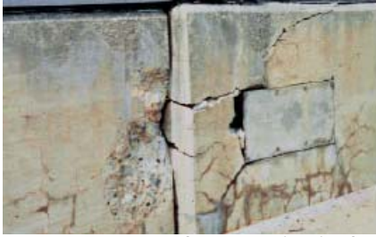
Fig. 1-7. La fisuración, el cerramiento de las juntas y la dislocación lateral fueron causados por la severa reactividad álcali-agregado en este muro de parapeto.
