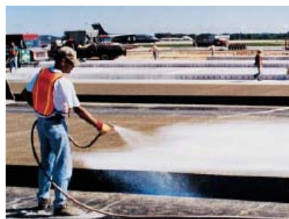
Fig. 6-31. Los compuestos líquidos formadores de películas se deben aplicar con cobertura uniforme y adecuada sobre toda la superficie y bordes para obtener un curado prolongado y efectivo.
