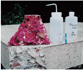
Fig. 7-18. La profundidad de la Carbonatación se determina a través del rociado de una solución de fenolftaleína sobre la superficie de concreto recién roto. Áreas no carbonatadas se vuelven moradas, las áreas carbonatadas permanecen sin color.
