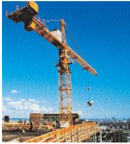
Fig. 5-11. La torre grúa y el cubo pueden manejar el concreto fácilmente en construcciones de edificios altos.
