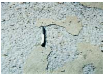
Fig. 3-13. Daños causados por la congelación (fragmentación) en las juntas de un pavimento (superior), fisuración por congelación inducida cerca de las juntas (inferior) y ampliación de la vista de las fisuras (foto menor, en la parte interna).
