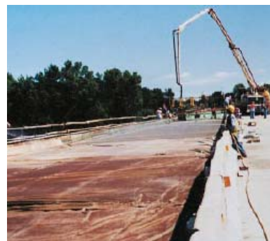
Fig. 6-26. El curado debe empezar en cuanto el concreto se endurezca suficientemente para prevenir la erosión de la superficie. El yute (arpillera, estopa) rociada con agua es un método efectivo para el curado húmedo.
