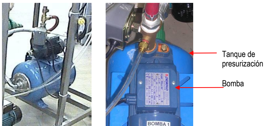
Figura 3.9. Componentes del equipo hidroneumático
