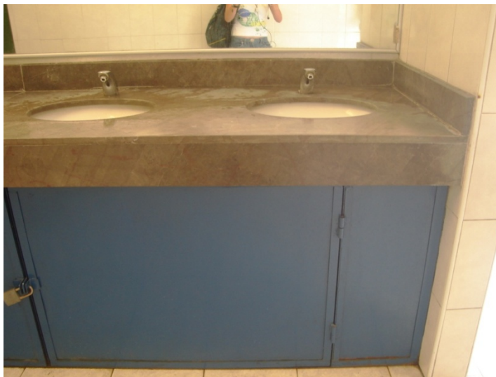
Figura IV.67. Lavamanos del edificio norte.
