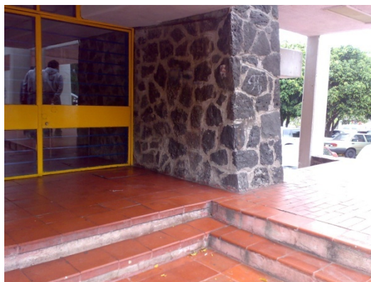
Figura V.3. Paso que se recomienda ampliar a 1.20 [m] de ancho
