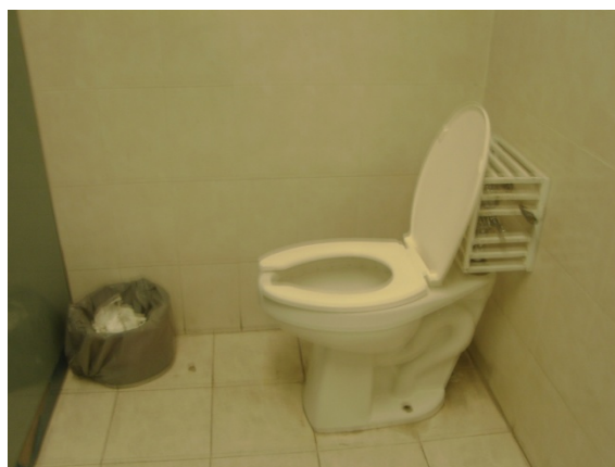
Figura IV.64. Inodoro del ala poniente, el cual no tiene barras de apoyo para personas con discapacidad.
