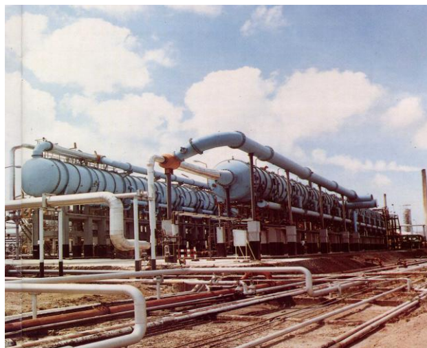
Figura 1.7 Desaladora MSF. Introducción a la Desalación. Curso impartido en el Instituto de Ingeniería de la UNAM, 28 de mayo del 2007 por José Antonio San Juan, Presidente de IDA.
