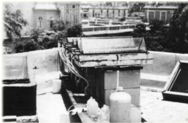
Figura 1.5 Destiladores solares de caseta en una azotea de La Habana Vieja. [XIII].
