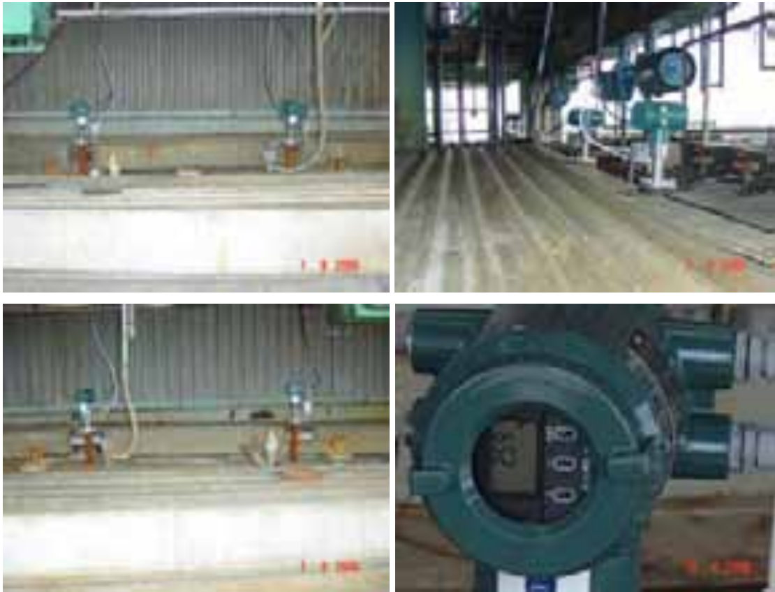
Figura 3.12. Analizadores de oxígeno en ductos
