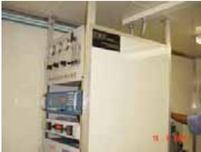
Figura 3.4. Gabinetes del sistema de adquisición de datos
