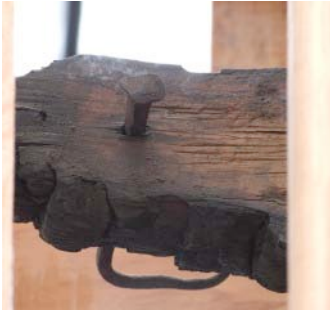
Fig. 19 Uno de los clavos de hierro atraviesa el travesaño en un área donde se calcinó por completo la tabla
