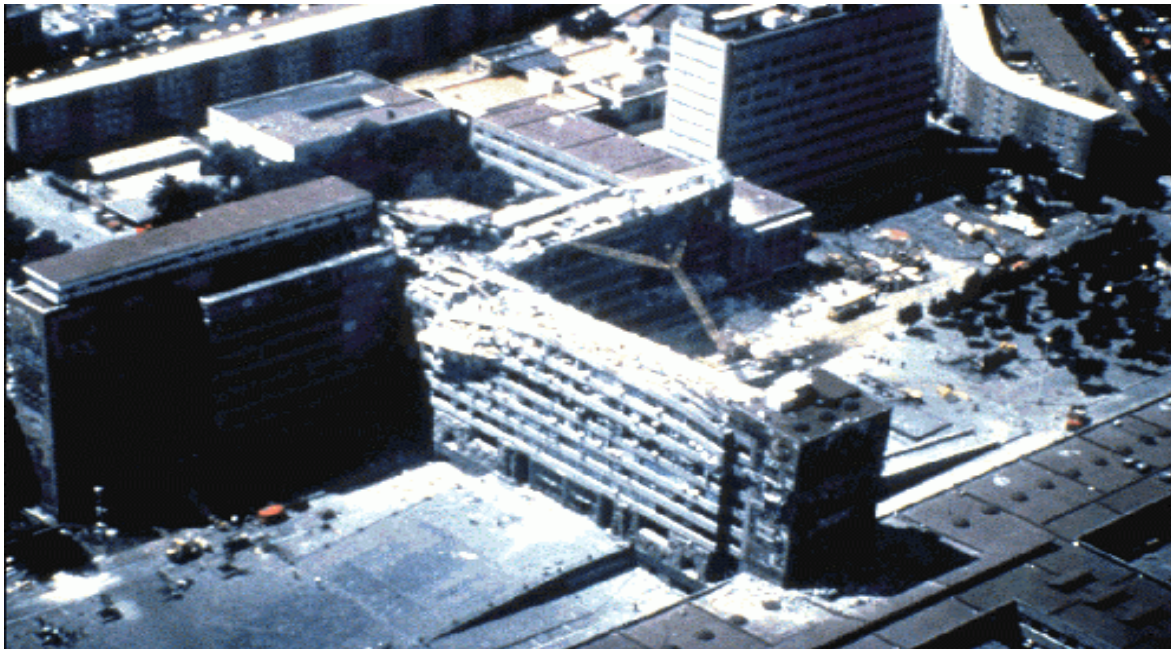
Figura 5.- Daños en el edificio de la Secretaría de Comunicaciones y Transportes
