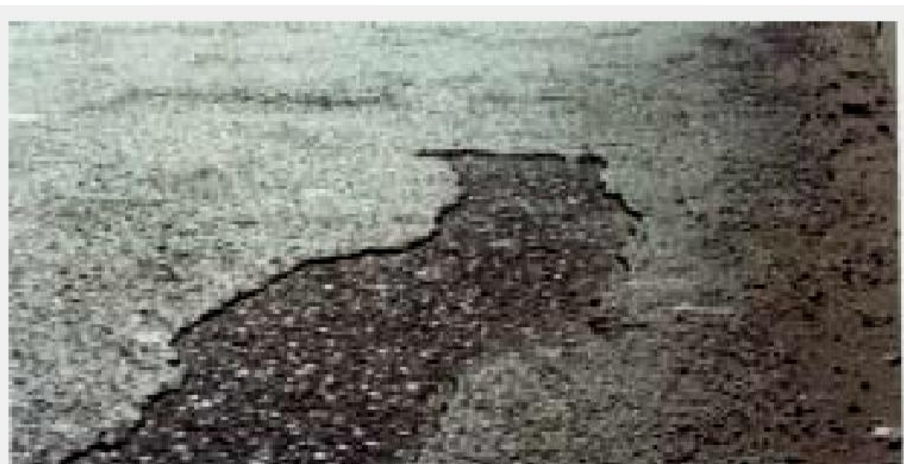
Peladura formando cavidades.
