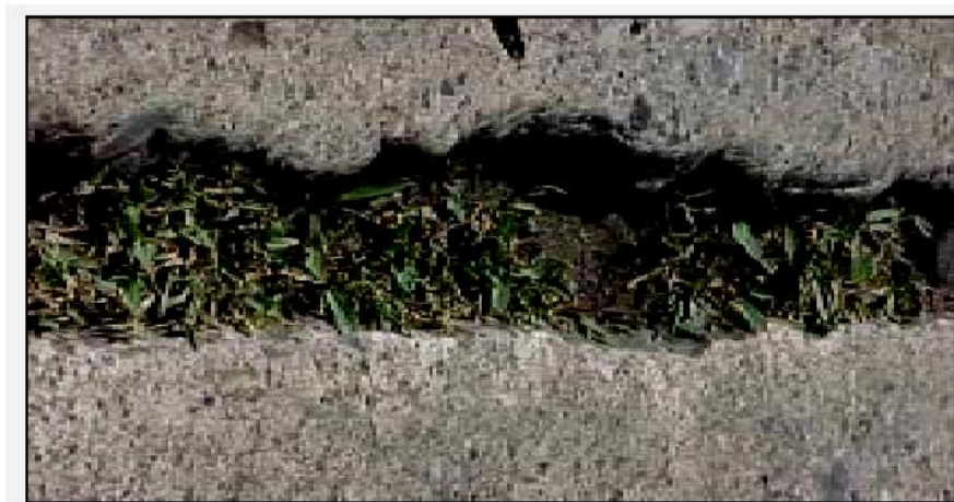
Junta con acumulación de materia orgánica.
