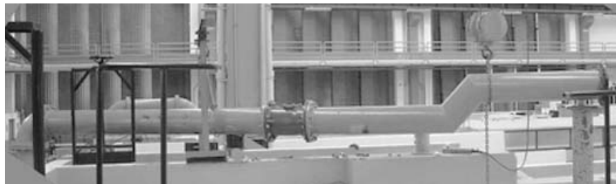
Figura 6.2 Fotografía del tren de descarga terminado.
