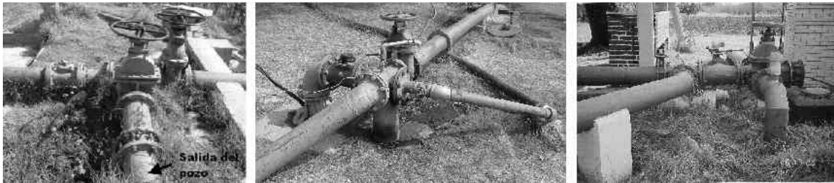
Figura 2.1 Tres casos de tramo recto insuficiente para la correcta colocación de un medidor.
