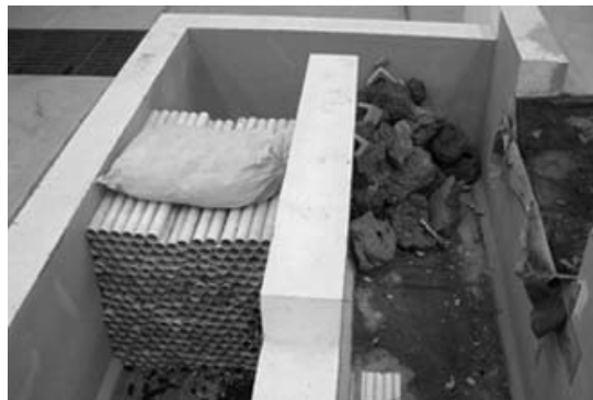
Figura 5.8 Piedras y tubos de PVC a manera de estabilizador y orientador de flujo en el canal de retorno.
