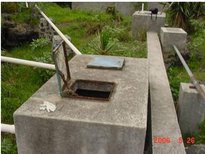
Figura A-3. Tanque homogenizador o sedimentador primario II
