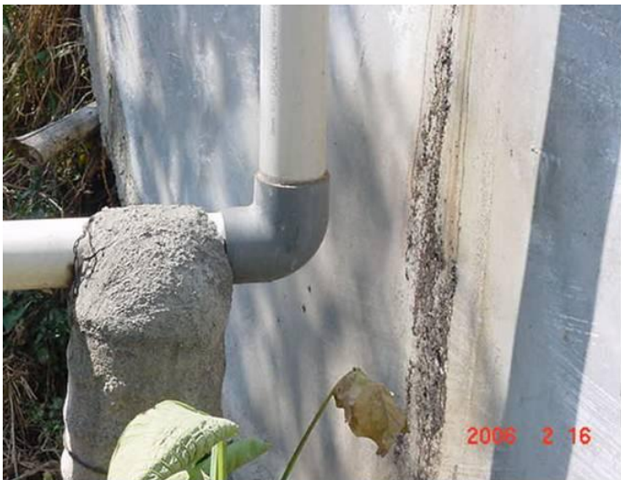
Figura A-2. Tubería de alimentación al HAFVD (fosa séptica)
