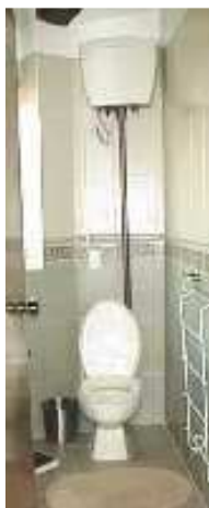
Foto 16 tanque de WC elevado 46
