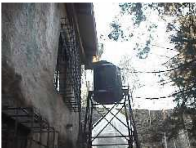
Foto 17 tinaco colector de agua pluvial 46
