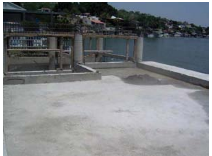
Colado de losa verde para reciclaje de agua. Propietario Dra. Maria de los Ángeles Fromow R. Apoyo de supervisión de obra. Arq. R.R.R.
