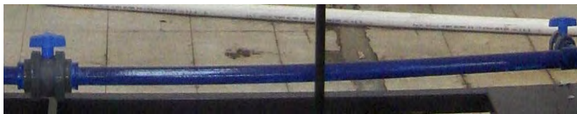
FIGURA 22. Tramo recto de tubería de 1"
