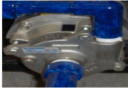
FIGURA 19. Área de succión y descarga de la bomba
