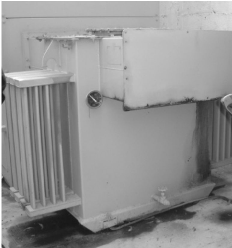
Figura 15. Daños que se pueden presentar en el tanque del transformador
