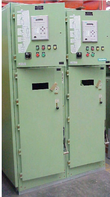
Figura 31. Tablero de MT ensamblado.
