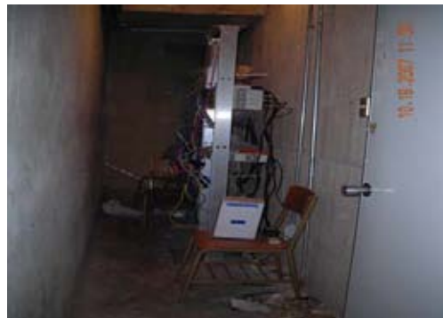
Figura 33 Malas condiciones en el cuarto de telecomunicaciones
