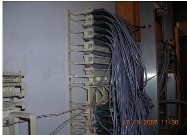
Figura 30 Cableado Estructurado Mal Organizado
