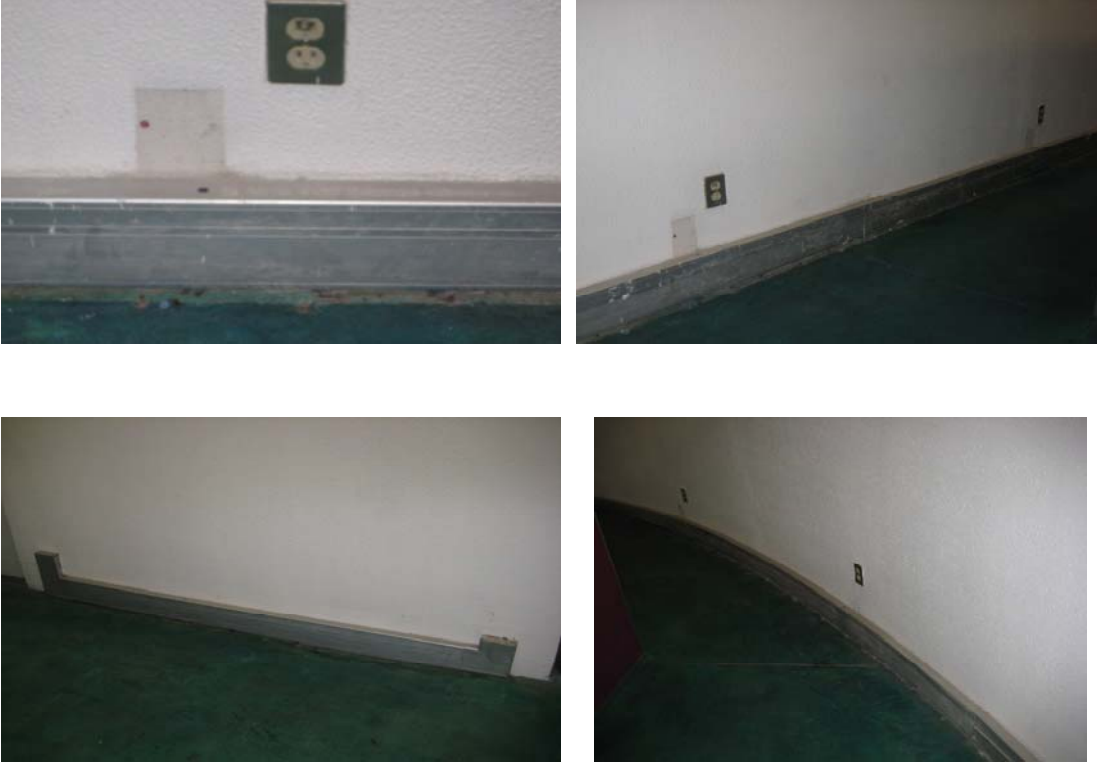
Figura 53 Canaletas en la Biblioteca Enrique Rivero Borrell
