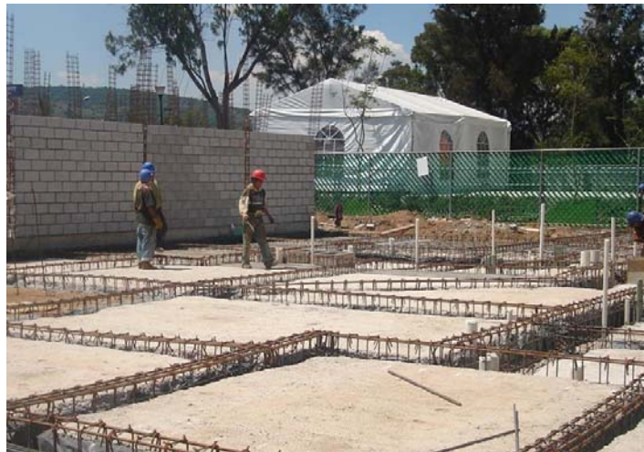
PLANTILLA Y ARMADO DE CONTRATRABES PARA RECIBIR EL ACERO PARA COLAR LA LOSA DE CIMENTACIÓN
