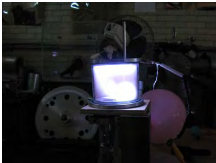
Figura 22. Imagen que muestra la presencia de arcos eléctricos
