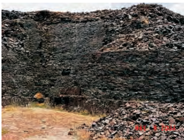
Área en la que es visible la falta de piedras.
