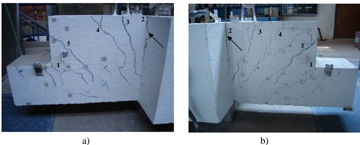
Figura 6.2. Falla por flexión en la unión viga-dado. a) Cara derecha, b) Cara izquierda
