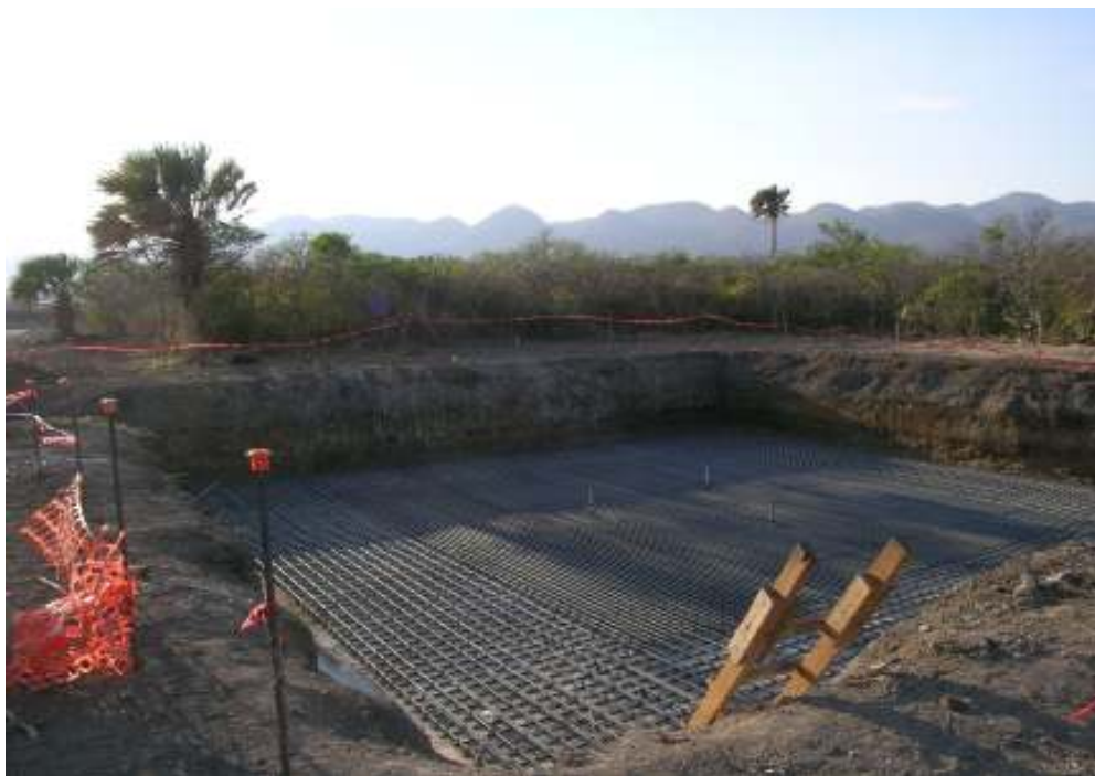
Instalación final para proceder a colocar placa de cemento que sostiene la torre de un aerogenerador.
