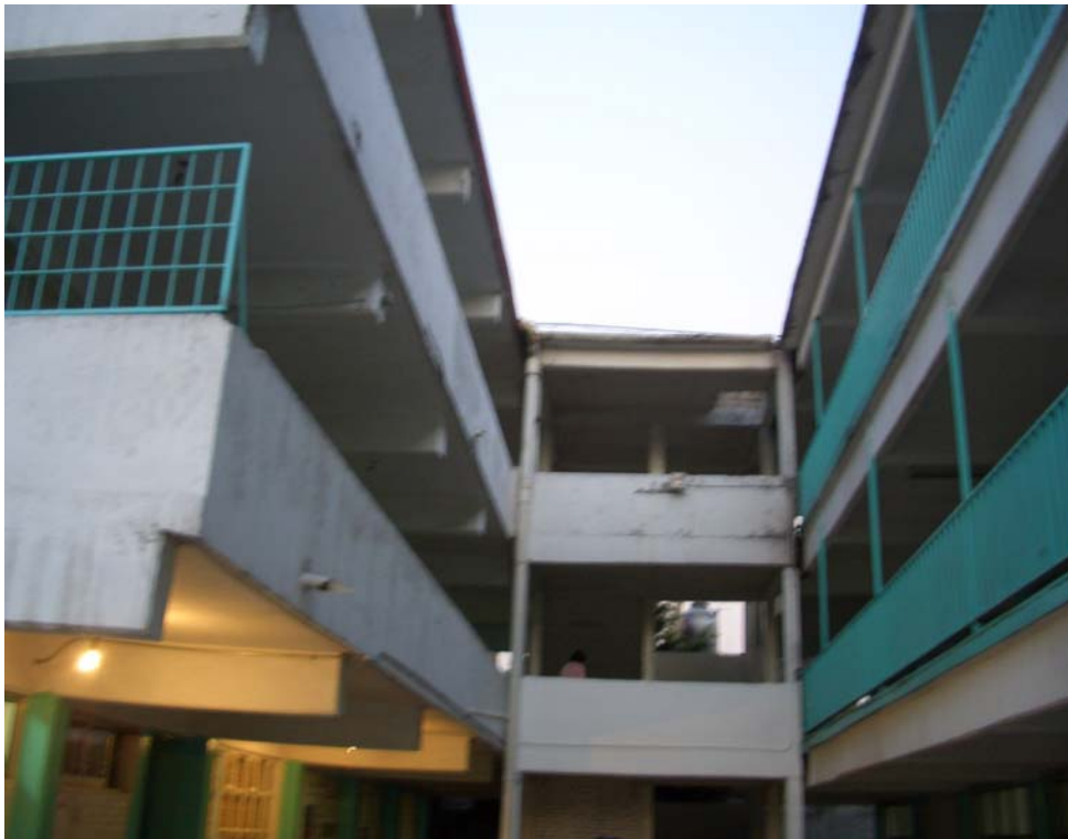
FOTOGRAFÍA 6. Muestra dos ejemplos de instalaciones construidas durante la segunda etapa. La segunda fotografía se tomó de manera reciente, situación por la cual las instalaciones presentan cierto deterioro.
