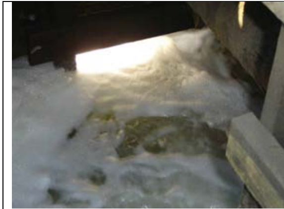
Figura 2.11 Falta pared de la tina de agua caliente.
