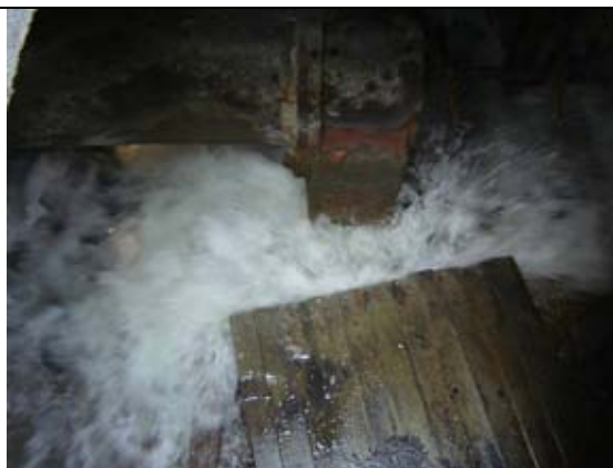
Figura 2.17 Caja de distribución mal acomodada
