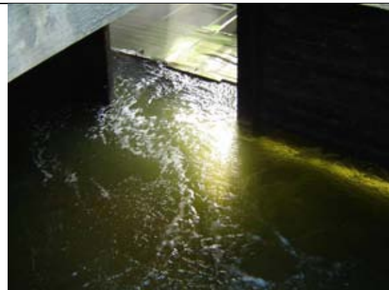
Figura 2.15 Falta pared de la tina de agua caliente.
