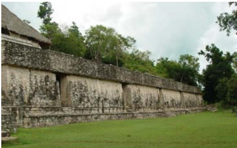
Ilustración 31.- Cuartos del ala este de la Acrópolis 1 a nivel de plaza. Foto del autor 2006.
