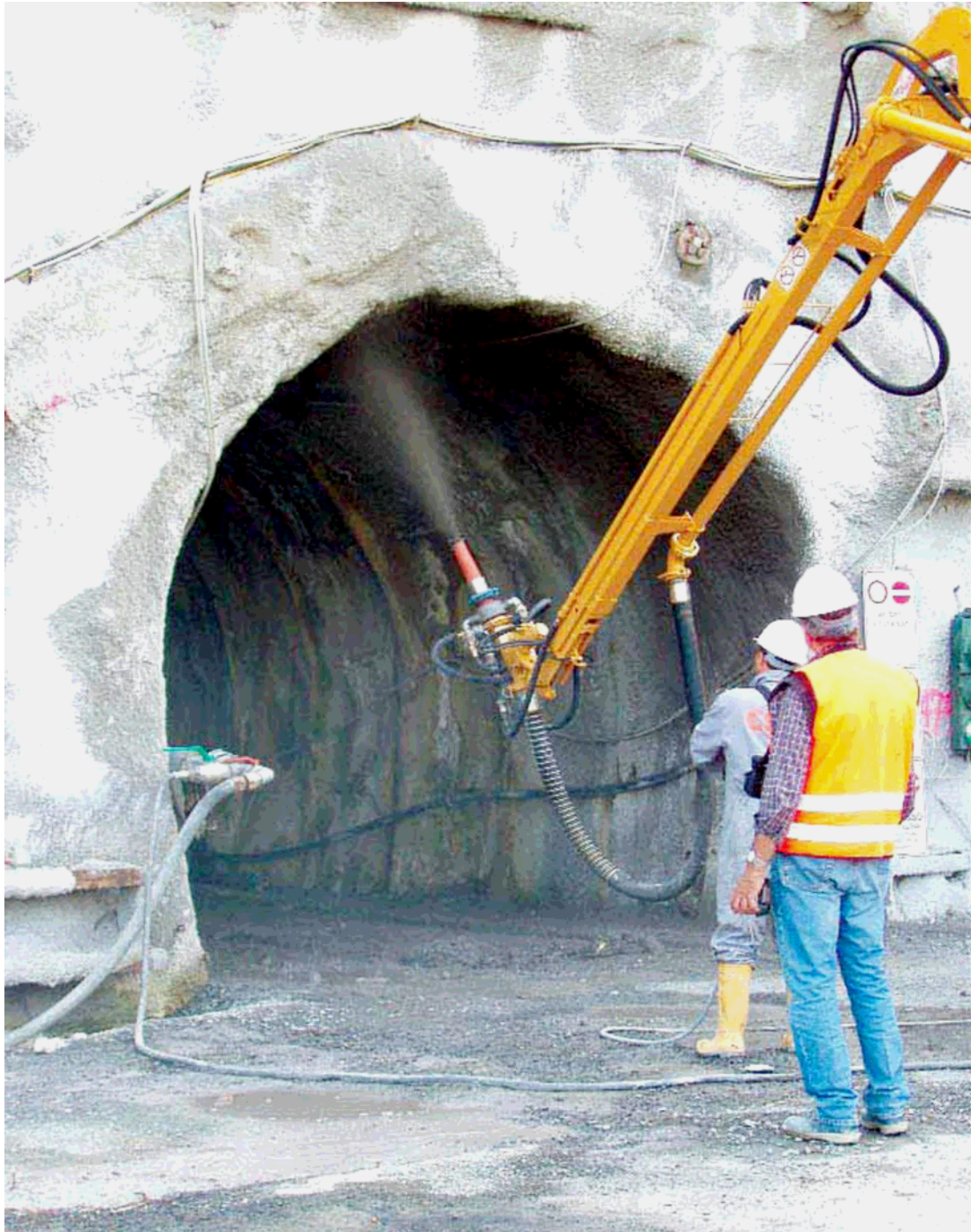
Foto. 5.18 En la fotografía vemos la colocación de Concreto Lanzado con el equipo proyector de concreto en el portal del túnel
