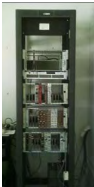
Figura 3.1 Fotografía del rack de 19" del Laboratorio de Física de Radiaciones en el IFUNAM. El primero cajón (de arriba hacia abajo) es el cajón CAMAC, los tres subsecuentes son NIM-bins con distintos módulos en cada uno de ellos.
